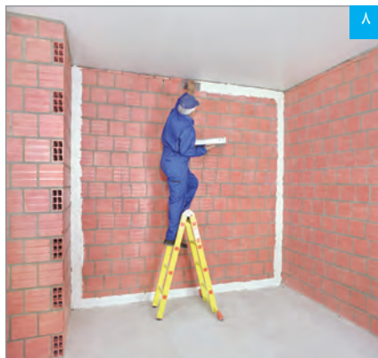
اجرای چسب گچی پنل (بوردفیکس) به صورت نوار پیوسته در حاشیه پیرامونی دیوار زمینه
