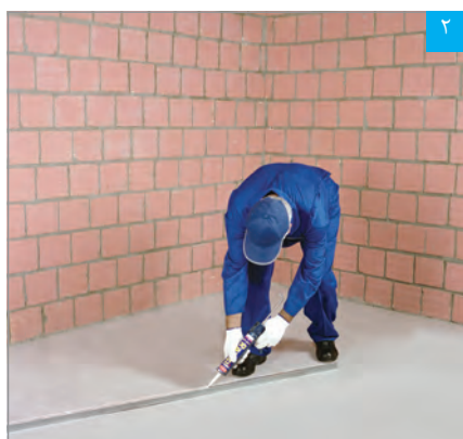
اجرای دو ردیف خمیر درزبند (یا نوار عایق) بر پشت سازه‌های هادی کف و سقف
